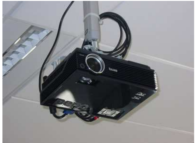
Einer von drei fest installierten Beamern im Neubau
