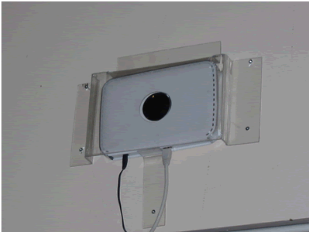
Einer von sechs Access-Points des Funknetzes
